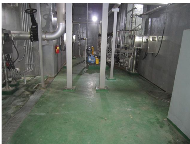
슬러지 이송 펌프
